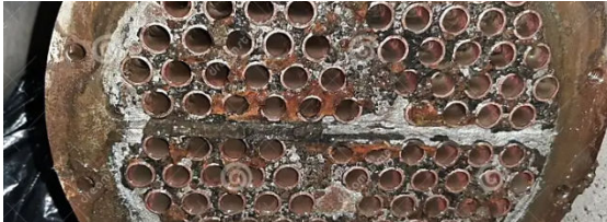
Şekil 9. Korozyona uğramış bir yağ eşanjörü
