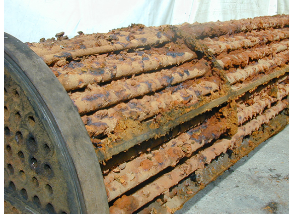
Şekil 5. Yoğun kirlenmiş yağ eşanjörü
