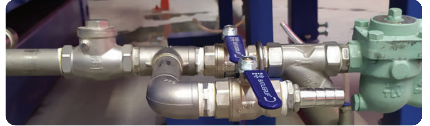
Resim 5: Kondens Tahliye Hattı
